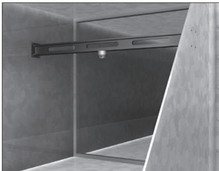
Rauchscharter im begehbaren Kanal
